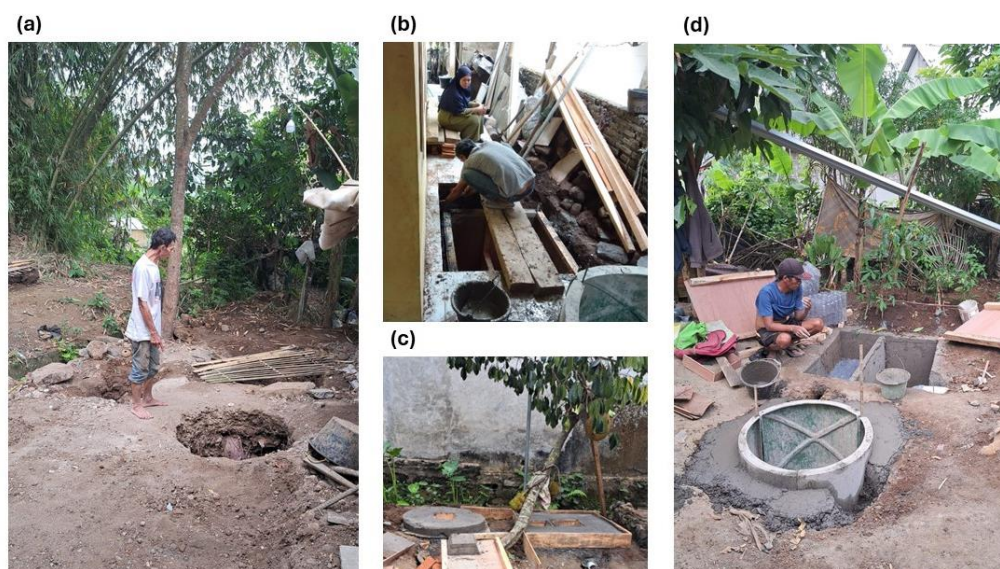
Gambar 3. (a) Awal konstruksi sanitasi warga; (b) Pembangunan dimulai; (c,d) Hasil akhir konstruksi.
