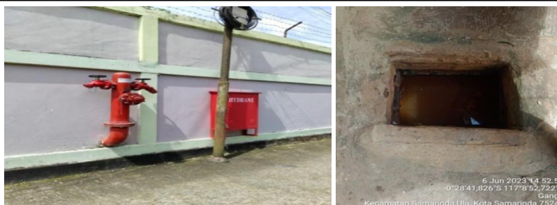
Gambar 15. Hidran dan Sumur Sumber: (Koleksi Pribadi, 2023)
