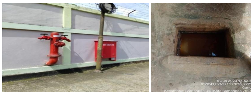
Gambar 15. Hidran dan Sumur Sumber: (Koleksi Pribadi, 2023)
