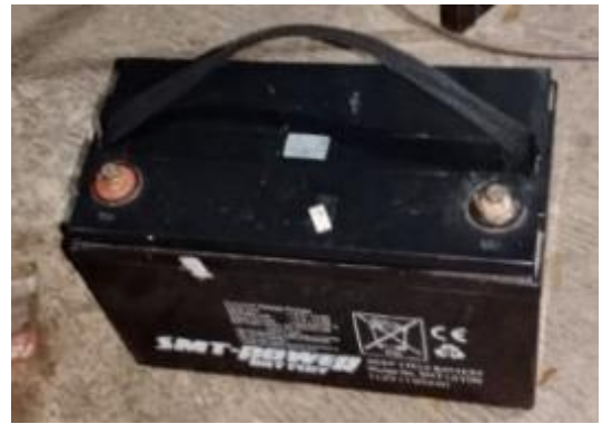
Gbr 1. Baterai 100 Ah
