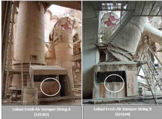
Gbr 6. Lokasi pemasangan FAD – Pabrik Indarung V
