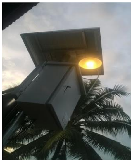
Gambar 6. PSU tenaga surya yang IBP
